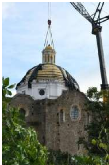
Figura 3.264. Daños en la cúpula del Templo de San Francisco Tepeyanco. Fuente: Twitter de la Secretaría de Cultura @mcristina_gc18
