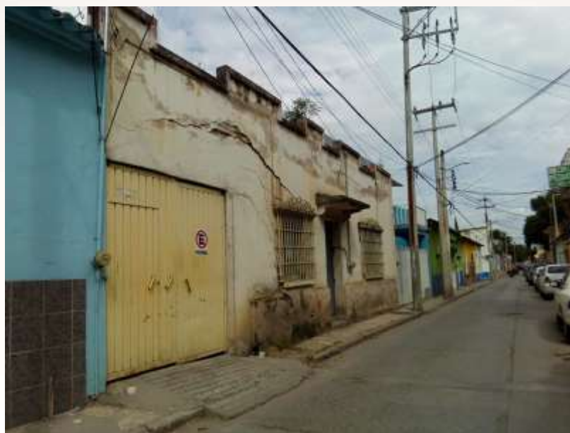
Figura 3.231. Vivienda dañada después del sismo del 19 de septiembre en el municipio de Iguala. Fuente: SSP, 2017
