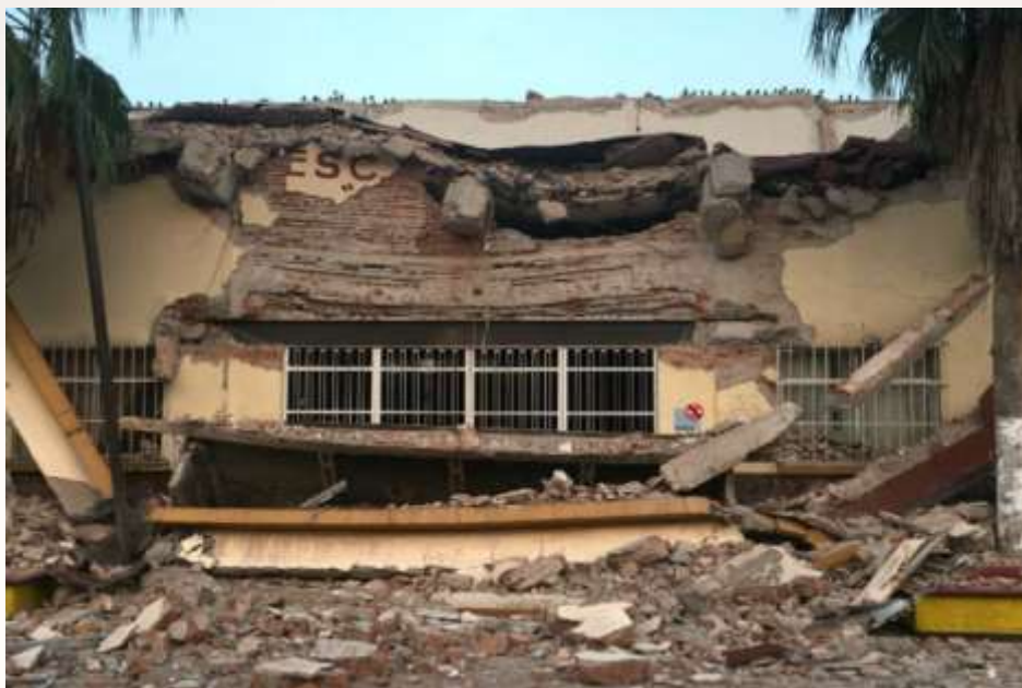
Figura 3.15. Escuela con colapso total en la Oaxaca.
