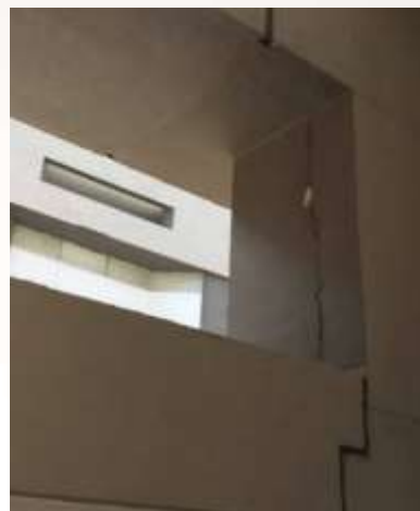
Figura 3.129. Fisuras en muros y través del Colegio. Fuente: Proceso, 2017
