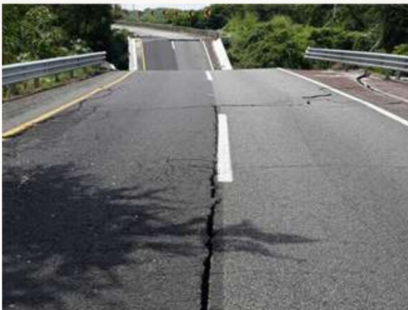
Figura 3.243. Colapso de tramo de la autopista México-Acapulco. Fuente: Excélsior , 2017
