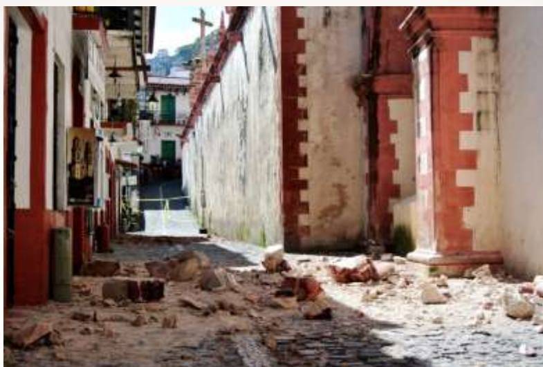
Figura 3.240. Daños en la fachada de Casa Borda, Taxco de Alarcón. Fuente: Sur Acapulco, 2017
