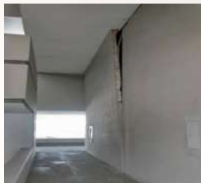
Figura 3.133. Desplome de muros de tablaroca. Fuente: Defensa, 2017
