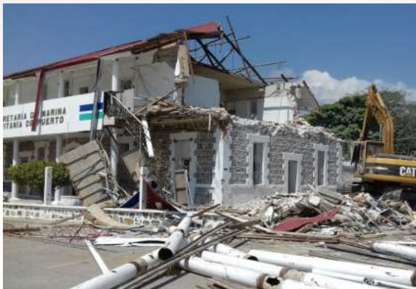
Figura 3.29. Capitanía de puertos a cargo de la SEDENA destruida. Fuente: Imparcial Oaxaca http://imparcialoaxaca.mx/istmo/129321/demuelen-edificio-de-capitania-de-puerto-en-salina-cruz-oaxaca/
