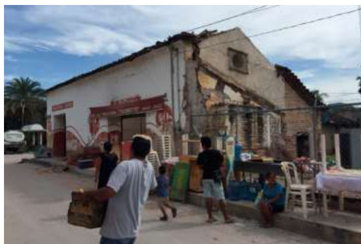
Figura 3.232. Vivienda dañada después del sismo del 19 de septiembre en el municipio de Atenango del Río. Fuente: Proceso , 2017
