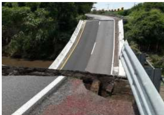
Figura 3.159. Puente vehicular desplomado en la carretera México-Acapulco, tramo Cuernavaca-Chilpancingo. Fuente: La Razón en https://www.razon.com.mx/tras-sismo-7-1-colapsa-puente-vehicular-en-la-mexico-acapulco/
