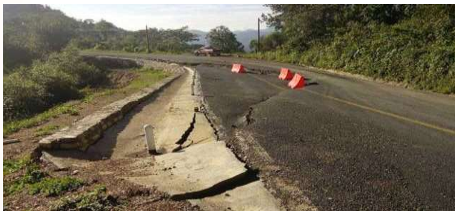
Figura 3.187. Daños en carretera tras el sismo en el estado de Puebla. Fuente: Municipios Puebla en http://municipiospuebla.mx/nota/2017-07-04/huauchinango/se-hunde-carretera-rehabilitada-por-la-sct-en-sierra-norte-de-puebla
