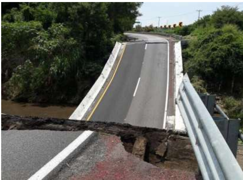
Figura 3.242. Puente vehicular dañado por sismo a la altura del kilómetro 109 de la autopista Cuernavaca-Acapulco. Fuente: Televisa, 2017
