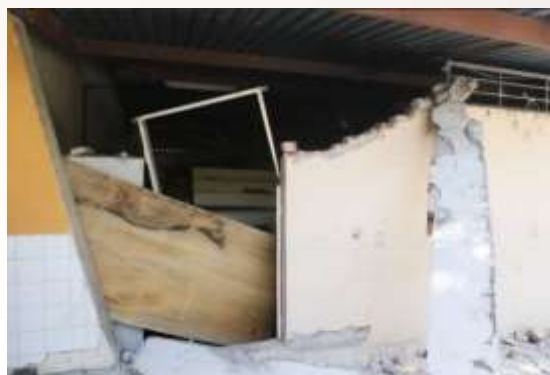
Figura 3.45. Daños Escuela primaria de Chiapas. Fuente: Noticieros Televisa https://noticieros.televisa.com/ultima-s-noticias/sep-reporta-casi-mil-escuelas-afectadas-sismo-chiapas/
