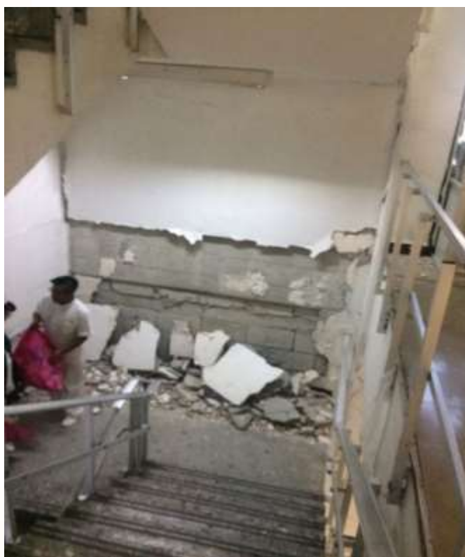
Figura 3.86. Daños en Hospital Regional 25. Fuente: https://reporterosenmovimiento.com/2017/09/20/aunque-la-clinica-25-del-imss-tiene-algunos-danos-estructurales-aun-no-sera-evacuada/
