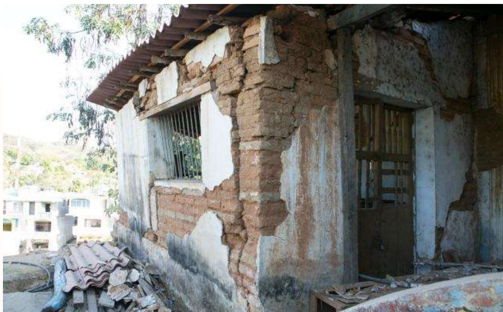
Figura 3.11. Casa con daño total donde se nota la ausencia de elementos estructurales. Fuente: http://www.eluniversal.com.mx/estados/aumenta-16-mil-las-viviendas-danadas-por-sismo-en-oaxaca
