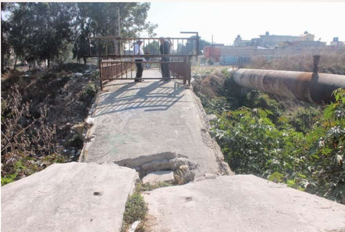
Figura 3.156. Infraestructura urbana destruida a causa del sismo en Morelos.
