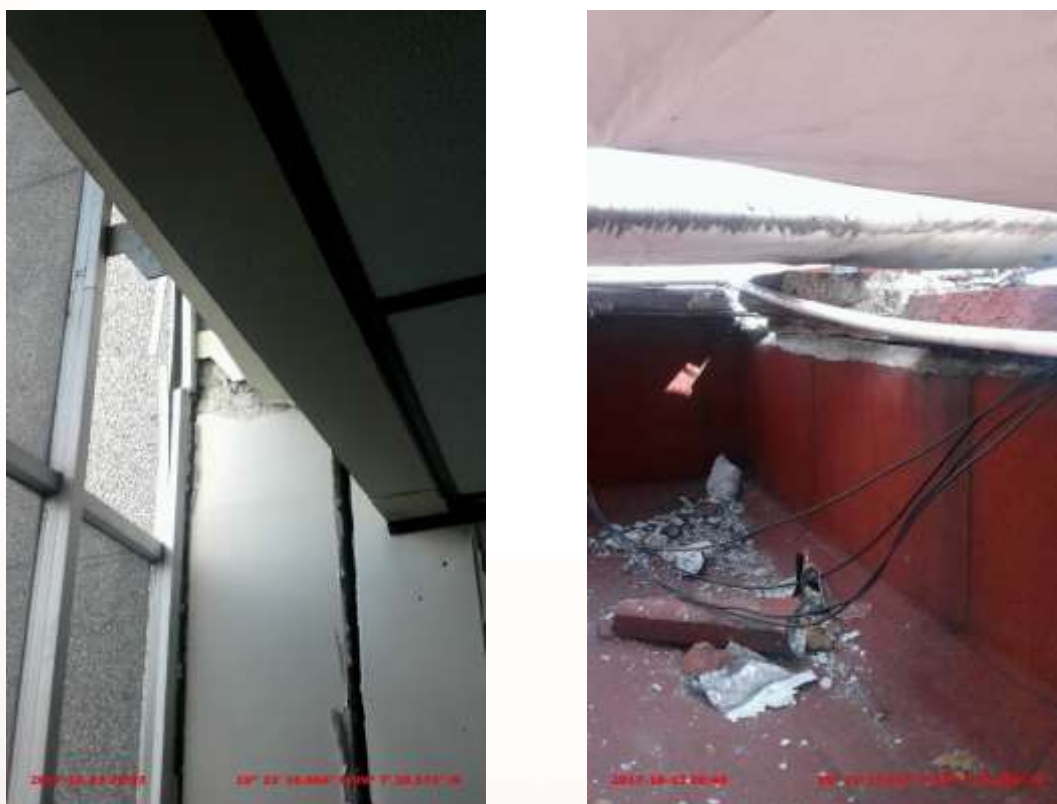
Figura 3.121. Daños en la estructura física de instalaciones de la Marina. Fuente: Secretaría de Marina
