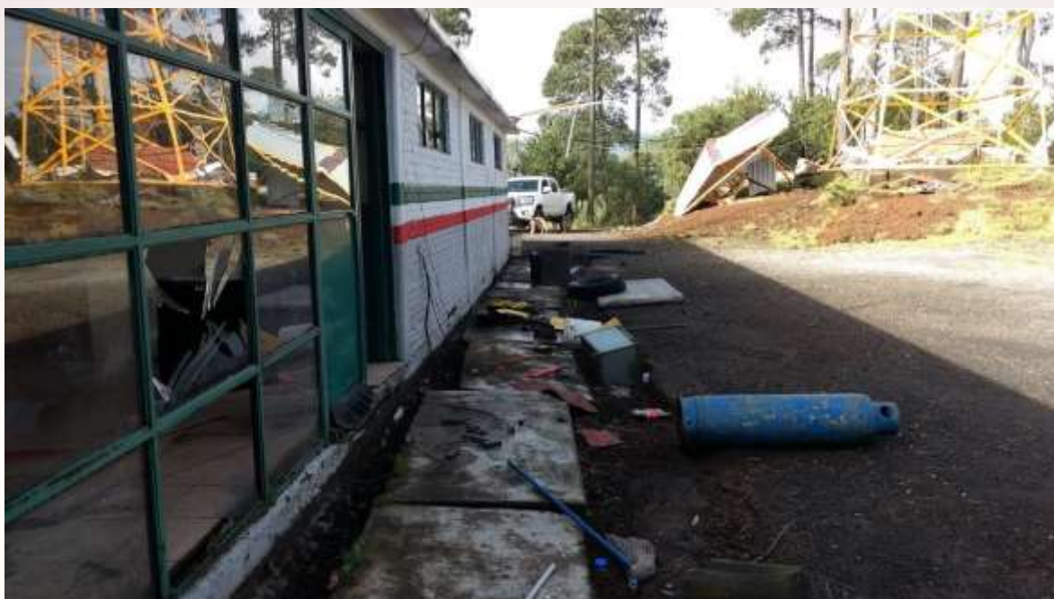
Figura 3.139. Daños en instalaciones del campamento forestal Cerro Panza. Fuente: CONAFOR, 2017
