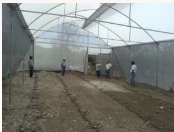
Figura 3.164. Varios viveros de la entidad sufrieron múltiples daños a causa del sismo. Fuente: Zona Centro Noticias en: http://www.zonacentronoticias.com/2014/05/entrega-de-viveros-forestales-en-areas-naturales-protegidas-de-morelos/
