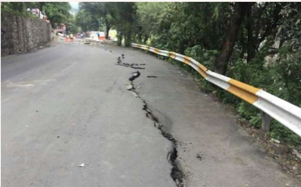
Figura 3.108. Daños en carretera vieja Xochimilco-Tulyehualco. Fuente: Agencia MANL en http://agenciamanl.blogspot.com/2017/10/carretera-vieja-xochimilco-tulyehualco.html
