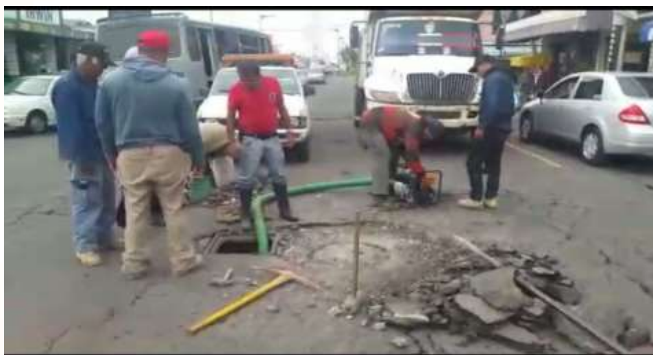
Figura 3.205. Ruptura de la red hidráulica, otra de las secuelas del movimiento telúrico.
