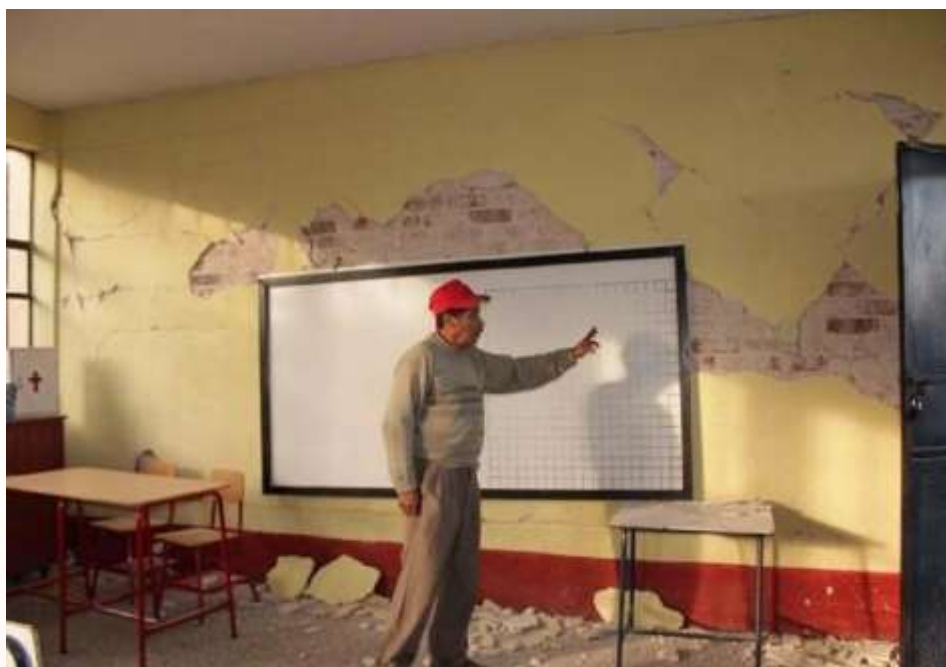
Figura 3.180. Escuela con diversos daños a consecuencia del sismo. Fuente: La capital en http://www.lacapital.com.mx/noticia/57422-Costara_mas_de_cuatro_mil_mdp_reconstruir_escuelas_danadas_por_sismo_SEP
