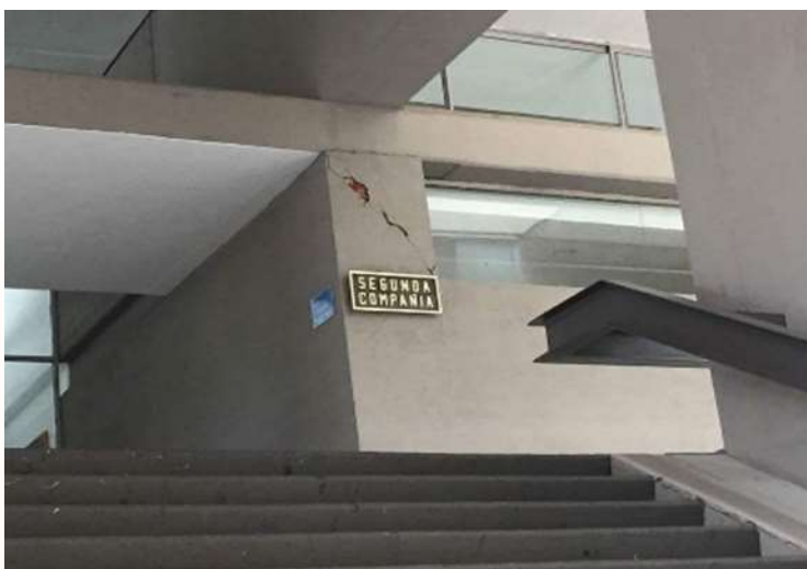
Figura 3.130. Fractura en la estructura del Colegio. Fuente: Proceso, 2017
