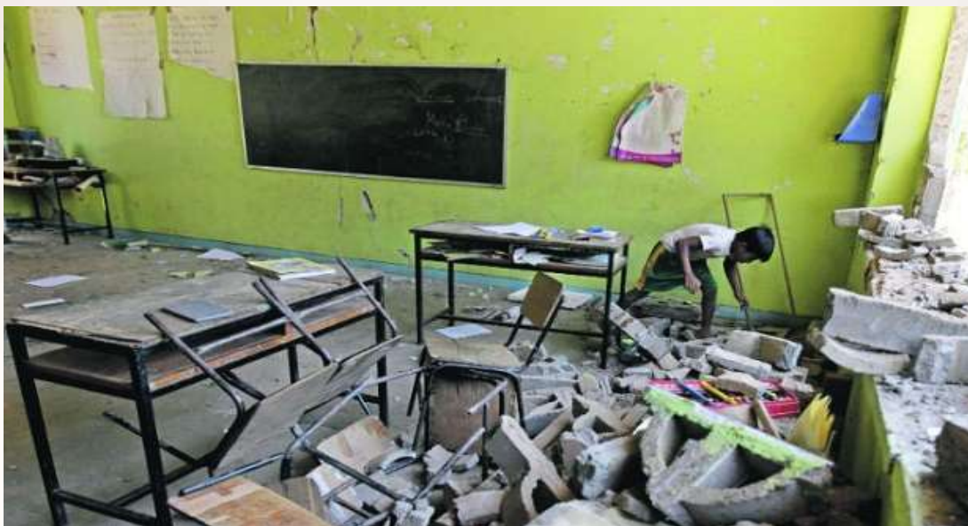
Figura 3.200. Daños graves en escuela primaria en el municipio de Ocuilan. Fuente: OMV radio en http://omvradio.com/cerca-de-500-estudiantes-de-ocuilan-siguen-a-la-espera-de-las-aulas-moviles-luego-del-pasado-sismo/
