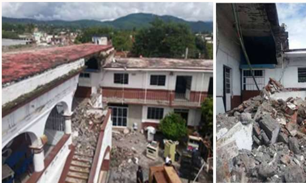
Figura 3.147. Instalaciones escolares derrumbadas a causa del sismo del 19 de septiembre.
