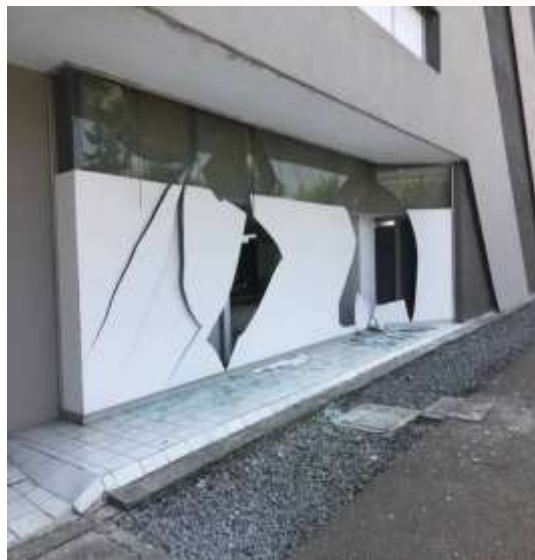
Figura 3.127. Daños en el Heroico Colegio Militar. Fuente: Proceso, 2017
