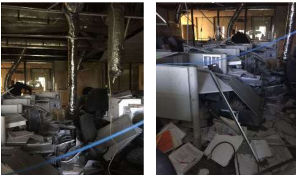
Figura 3.131. Desplome de muros y mampostería de relleno. Fuente: Defensa, 2017
