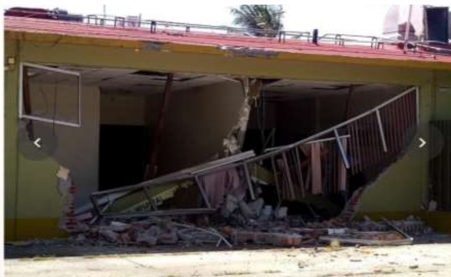
Figura 3.18. Hospital General "Macedonio Benítez Fuentes" en Juchitán, dañado por el sismo. Fuente: NVI Noticias https://www.nvinoticias.com/nota/70030/evaluan-reconstruir-hospital-de-juchitan-oaxaca
