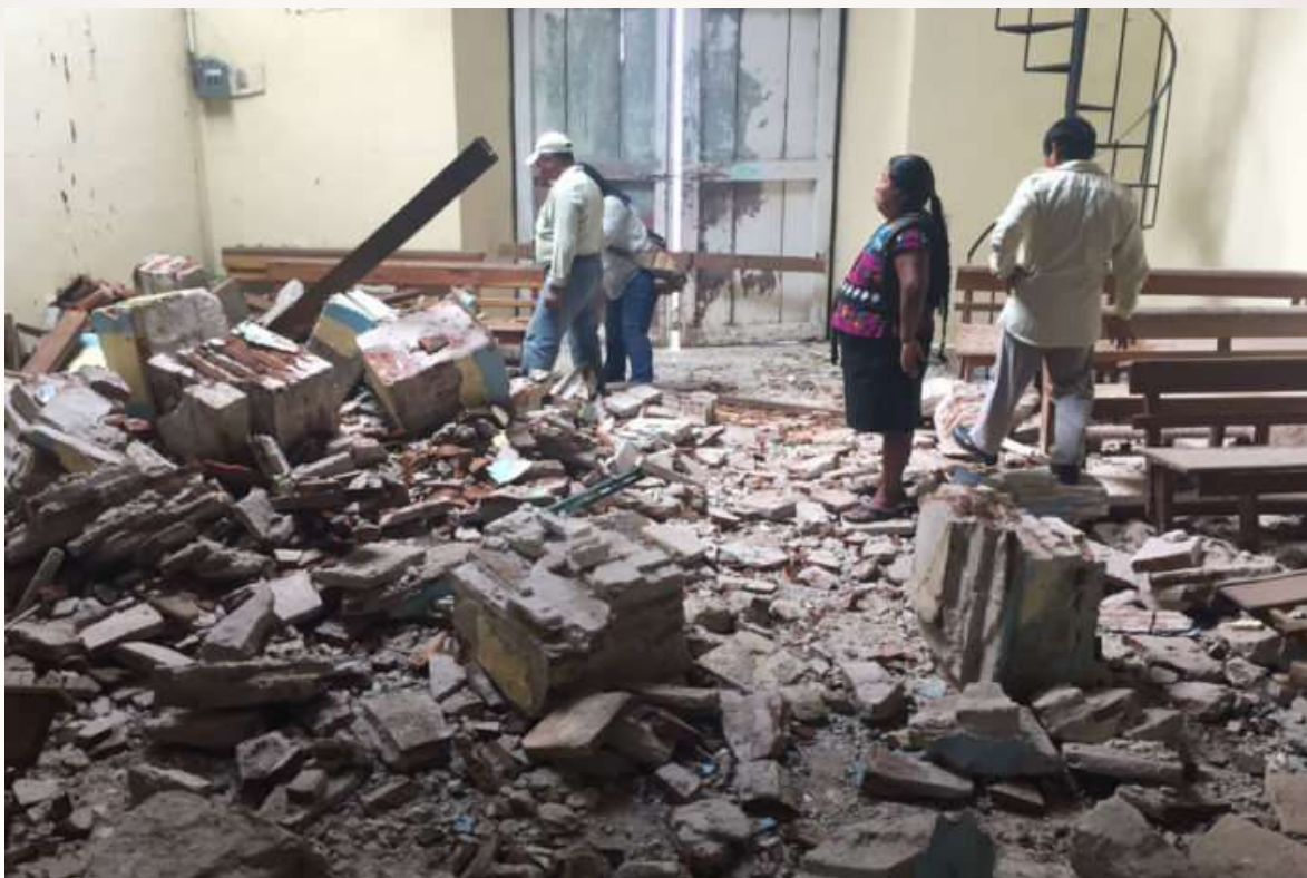
Figura 3.40. Afectaciones en viviendas a causa del sismo de septiembre. Fuente: Proceso https://www.proceso.com.mx/503976/contabilizan-en-chiapas-80-mil-500-viviendas-afectadas-sismo-del-7-septiembre
