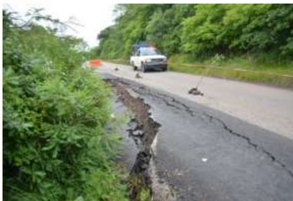
Figura 3.158 Daños causados por el sismo a la infraestructura carretera en Morelos. Fuente: Sur Digital Medios en https://www.surdigital.com.mx/2017/08/30/cierran-carretera-ayala-a-tlaltizapan-por-desgajamiento/
