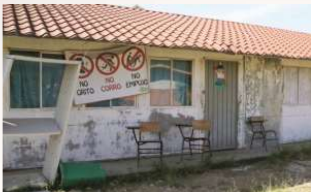
Figura 3.44. Daños en la escuela primaria Cuauhtémoc, municipio de Villaflores. Fuente: El Universal http://www.eluniversal.com.mx/estados/dona-japon-78-mil-dolares-para-reconstruccion-de-primaria-en-chiapas
