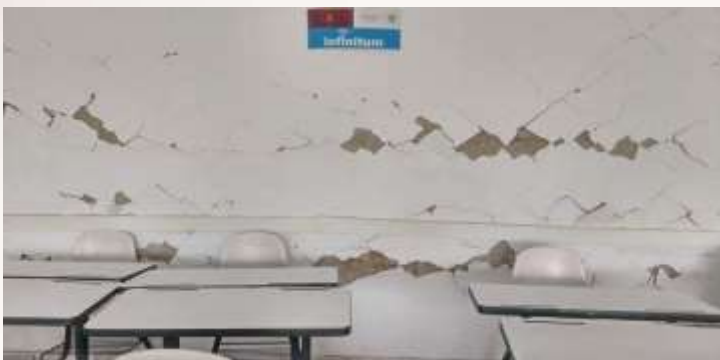
Figura 3.132. Salones afectados. Fuente: Proceso, 2017
