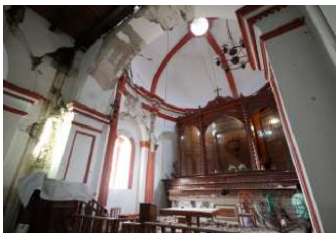
Figura 3.58. Daños en el templo El Calvario, municipio de Chiapa de Corzo. Fuente: http://yucatan.com.mx/mexico/serios-danos-iglesias-chiapas
