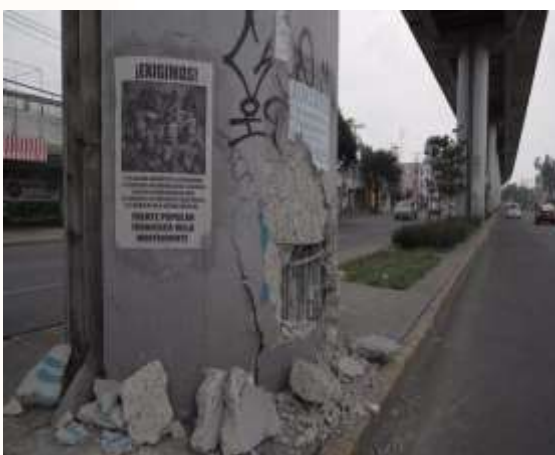
Figura 3.109. Daños en columna tramo Nopalera-Olivos a causa del sismo. Fuente: El Universal en http://www.eluniversal.com.mx/metro/opol/cdmx/concluye-servicio-temporal-de-autobuses-en-olivos-tlahuac
