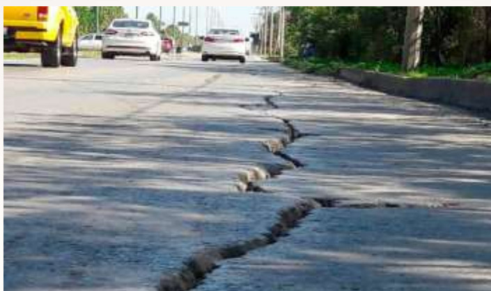
Figura 3.157. Avenida con grieta transversal causada por el sismo del 19 de septiembre en Morelos. Fuente: Expreso.press en https://expreso.press/2016/04/21/falta-de-mantenimiento-agrieta-concreto-hidraulico-del-eje-vial/
