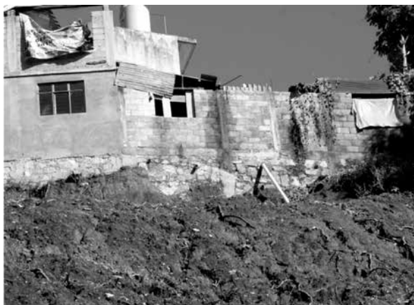
Figura 6 ESCARPE DE FALLA CERCANO A LAS VIVIENDAS DE LA CALLE NIGROMANTE EN LA CIUDAD DE HUAUCHINANGO. NÓTESE LA TUBERÍA HACIA LA LADERA
