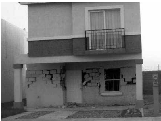
Daño en edificación de vivienda, Mexicali, 2010.
