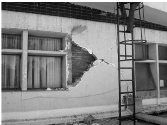
Daño en elementos no estructurales de edificación para hospital, Mexicali, 2010.
