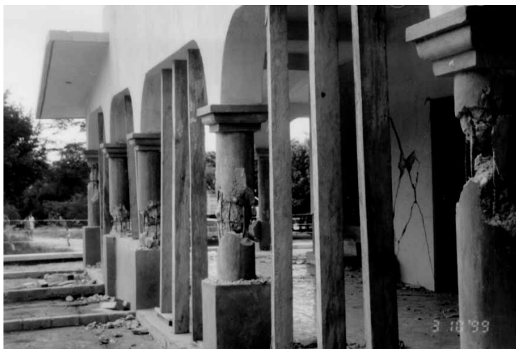
Figura 31 - Daño observado en la Clínica de Salud de Santa María Colotepec (Lermo, 1999)
