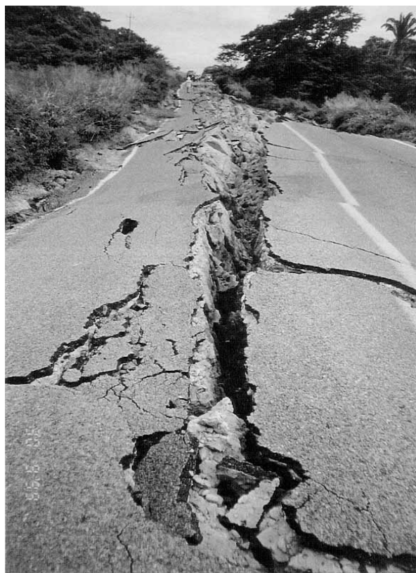
Figura 30 - Daño ocasionado en la carretera Pinotepa Nacional a Salina Cruz (Cortesía de SCT Delegación Oaxaca)
