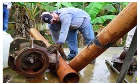
Figura 2.121 Afectaciones en infraestructura hidráulica
