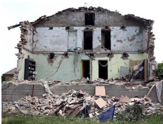
Figura 7.7 Terremoto que causó graves daños en una vivienda en Cavezzo, Italia. Foto: EFE
