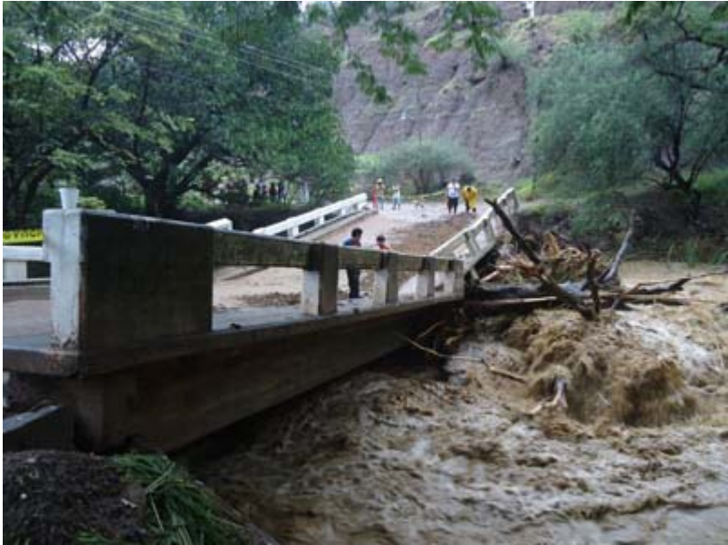
Figura 2.101 Puente colapsado en el municipio de San Juan Bautista Cuicatlán
