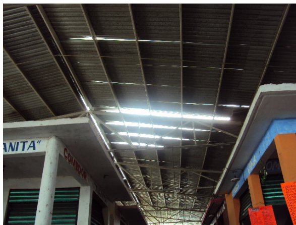
Figura 2.54 Daños en techos del mercado municipal
