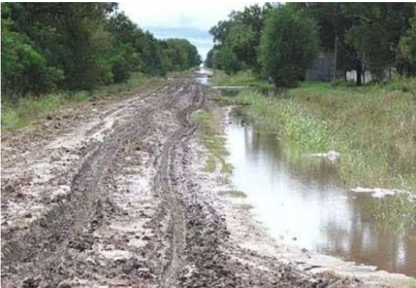
Figura 2.125 Daños en caminos rurales a consecuencia de Ernesto . Fuente: Coatzadigital
