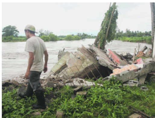
Figura 2.117 Daño total en vivienda asentada en los márgenes de un río
