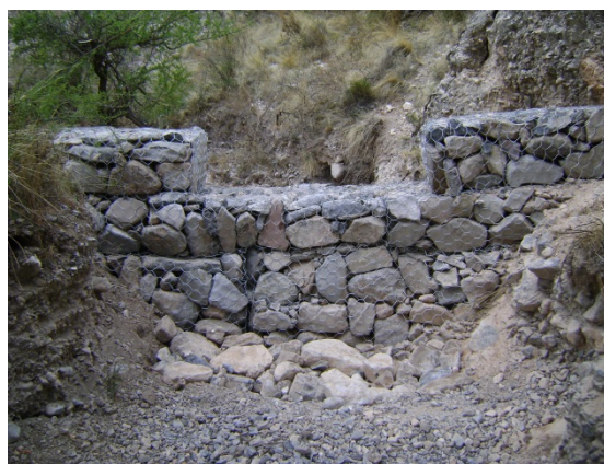
Presa de gaviones
