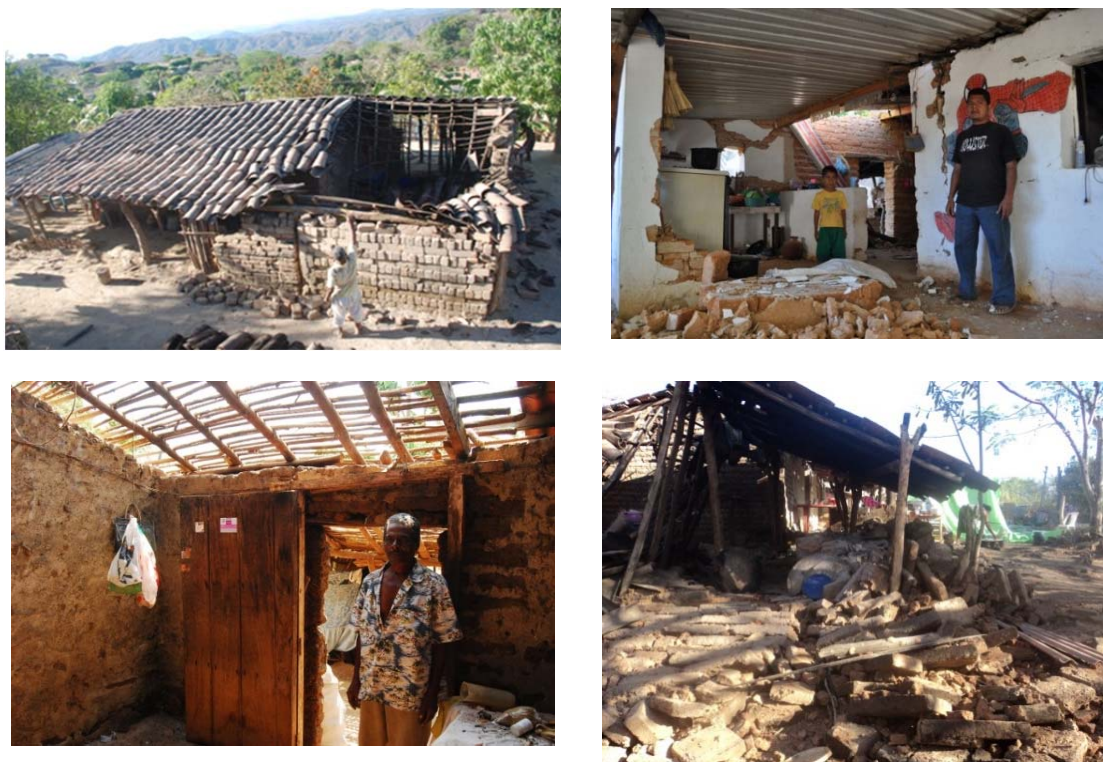
Figura 3.50 Viviendas destruidas por el sismo
