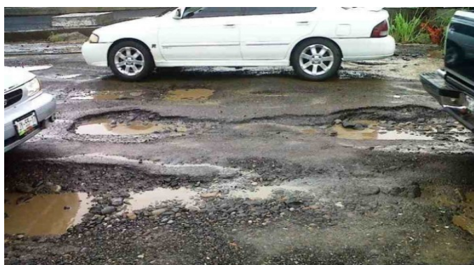
Figura 2.127 Vialidad afectada por las intensas lluvias provocadas por Ernesto en el municipio de Xalapa. Fuente: Código Crítico
