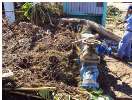
Figura 2.47 Daños en infraestructura de agua potable
