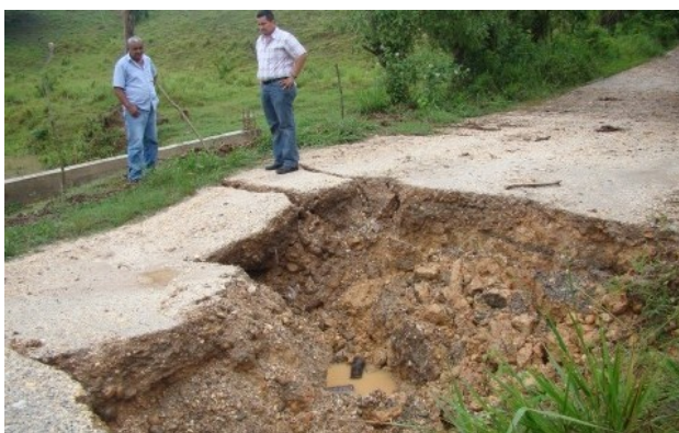
Figura 2.11 Daños en caminos rurales de Playa Vicente, Veracruz a consecuencia de las intensas lluvias de junio de 2012
