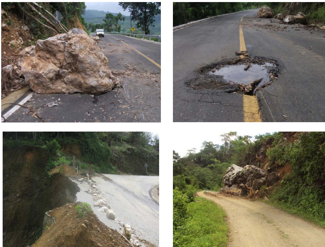
Figura 3.57 Diversos tipos de afectaciones en caminos a causa del sismo
