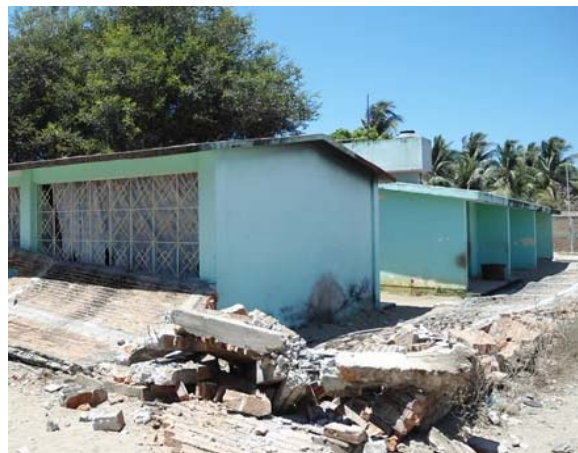
Figura 3.38 Escuela afectada en el municipio Marquelia. Foto: El Faro de la Costa Chica
