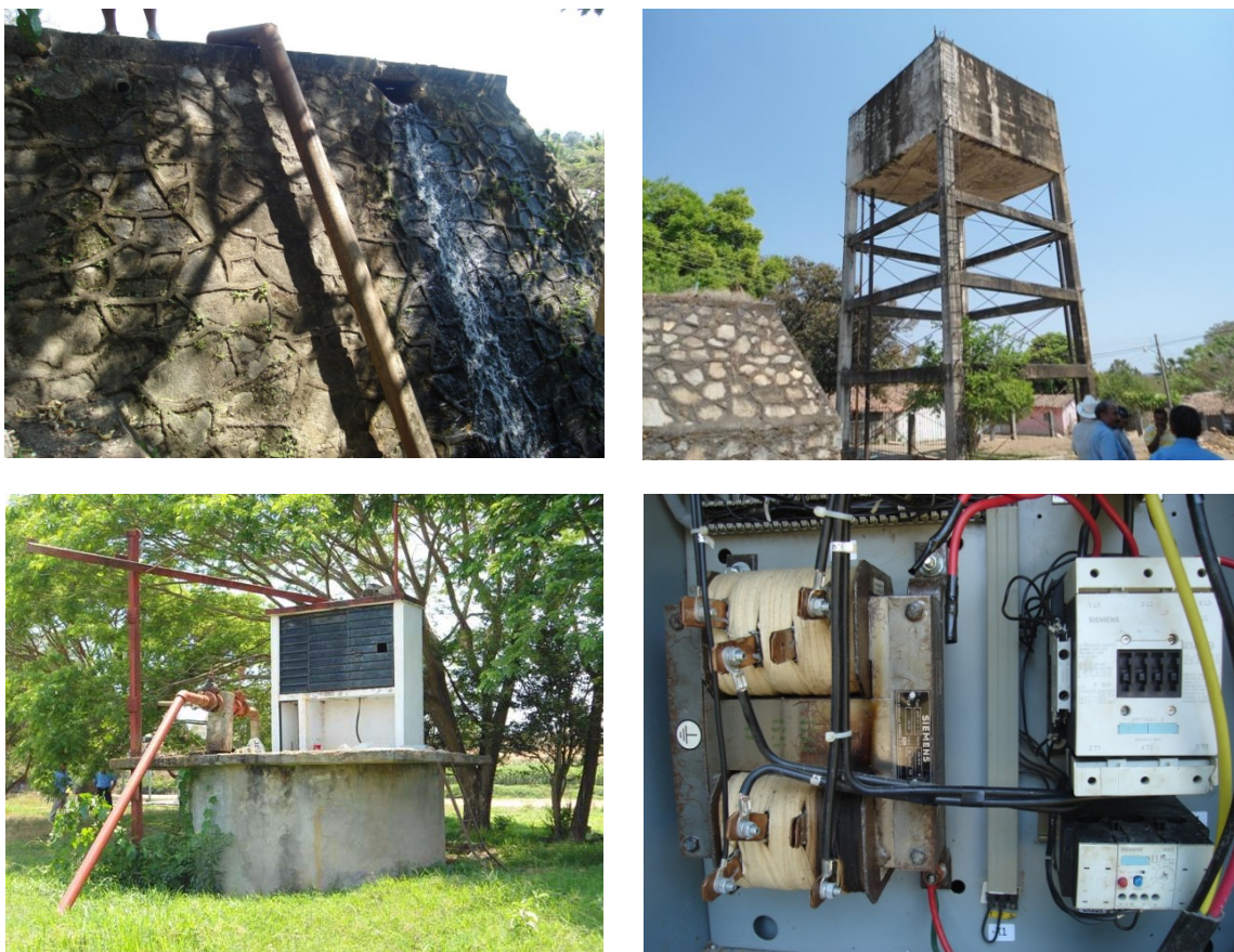
Figura 3.55 Diversos tipos de afectaciones en instalaciones y equipo a causa del sismo
