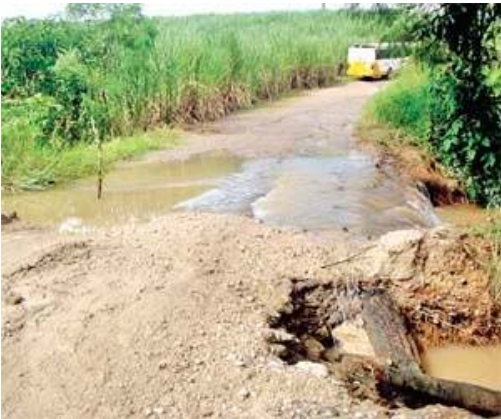
Figura 2.124 Daños en carretera Rancho Nuevo-Temascalapa. Fuente: El Sol de Orizaba
