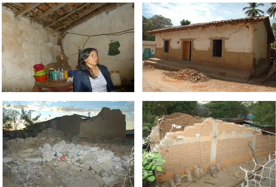
Figura 3.28 Diversos tipos de afectaciones en vivienda
