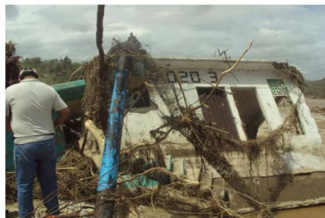
Figura 2.46 Daños en el pozo 3, Puerto Escondido
