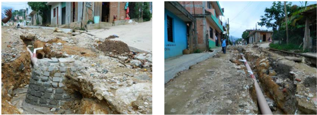
Figura 2.48 Daños en la red de drenaje del municipio de Santa Catarina Juquila
