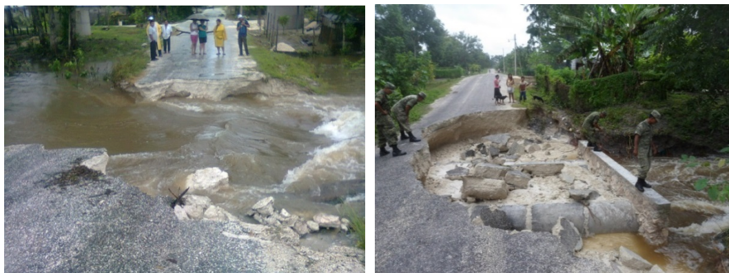
Figura 2.94 Afectaciones en el sector carretero como consecuencia del huracán Ernesto en Campeche. Fuente: campechenoticias.com.mx
