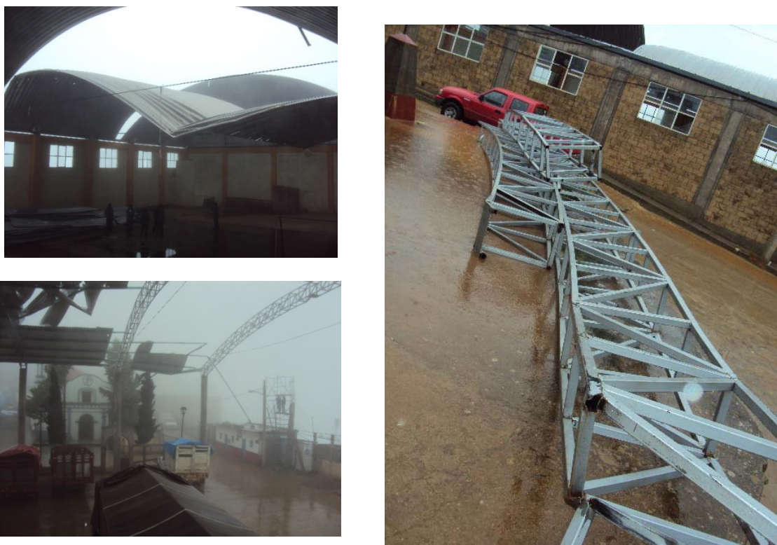
Figura 2.55 Daños en infraestructura urbana del municipio de San Pedro El Alto
