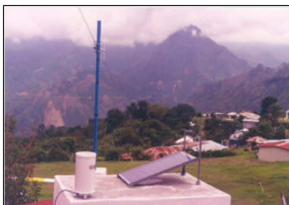
6.4 Pluviómetro, celda solar y antena de radio sobre el techo del, centro de salud, estación Agua Caliente AC-03
