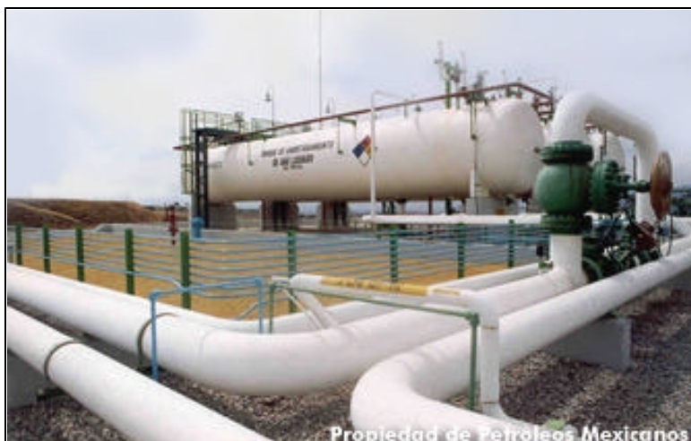
Figura 5.6 Terminal de almacenamiento de gas licuado, Tepeji del Río, Qro. (PEMEX e , 2001).
