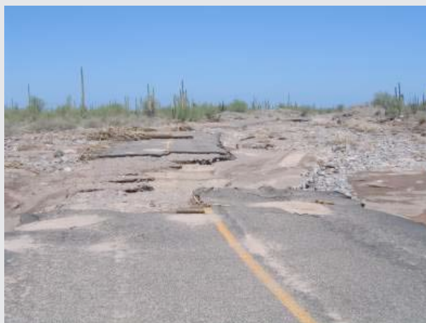
Camino destruido en Santa Rosalía
