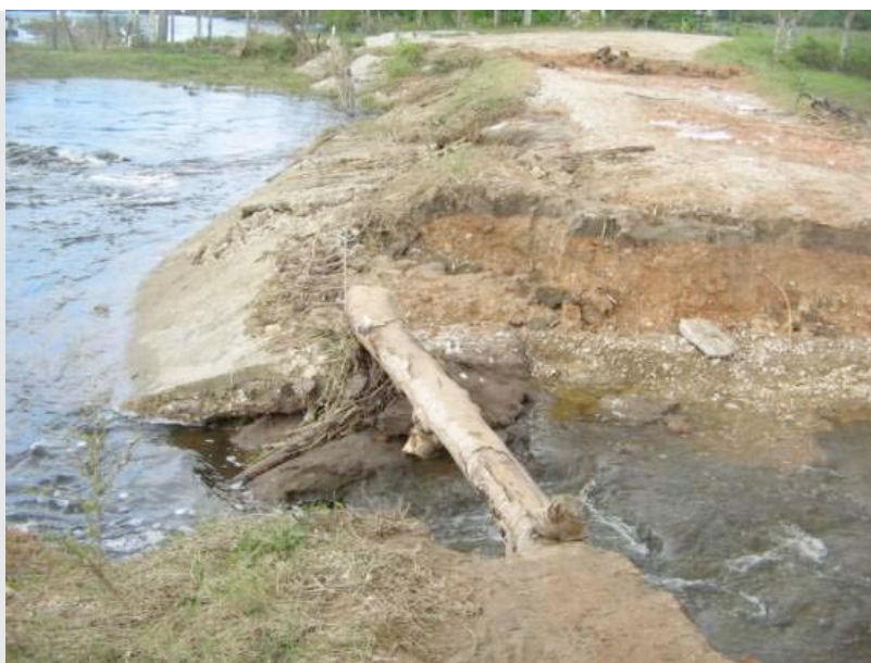
Figura 2.127 Destrucción de cruces por insuficiencia de la alcantarilla deja a la comunidad de Pico de Oro incomunicada
