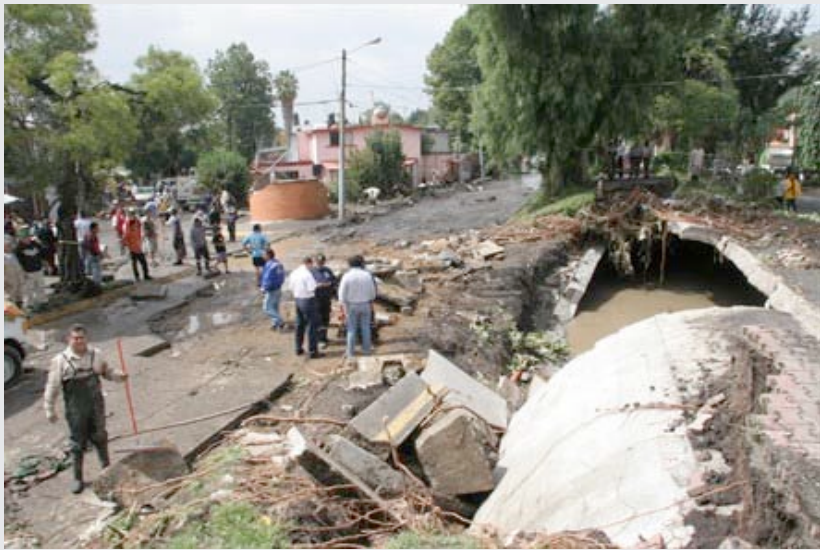
Figura 2.35 Ruptura del túnel Emisor Poniente en el municipios de Tlalnepantla, Estado de México
