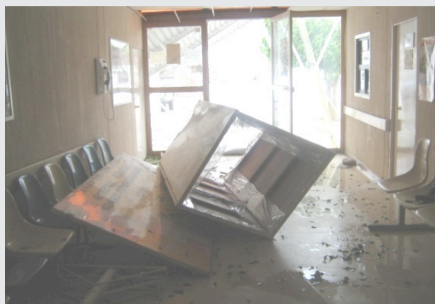
Mobiliario afectado del centro de salud urbano de ciudad Constitución
