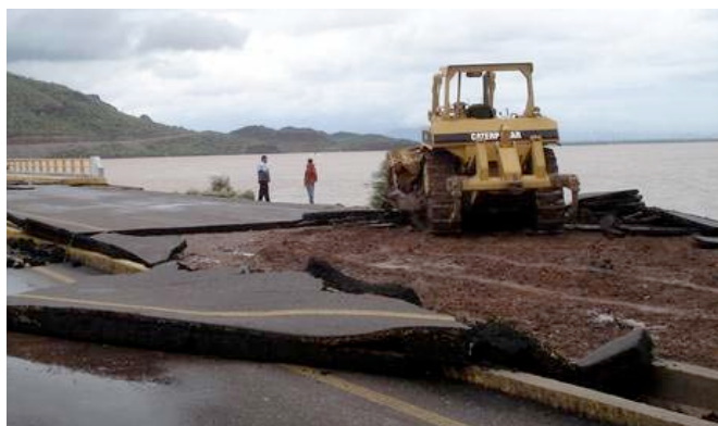
Figura 2.98 Daños en la superficie de rodamiento de la carretera federal 15 en el municipio de Guaymas
