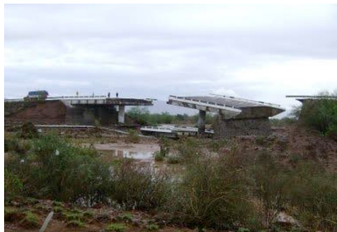
Figura 2.100 Daños en puente Guaymas-Hilo antes El Valiente
