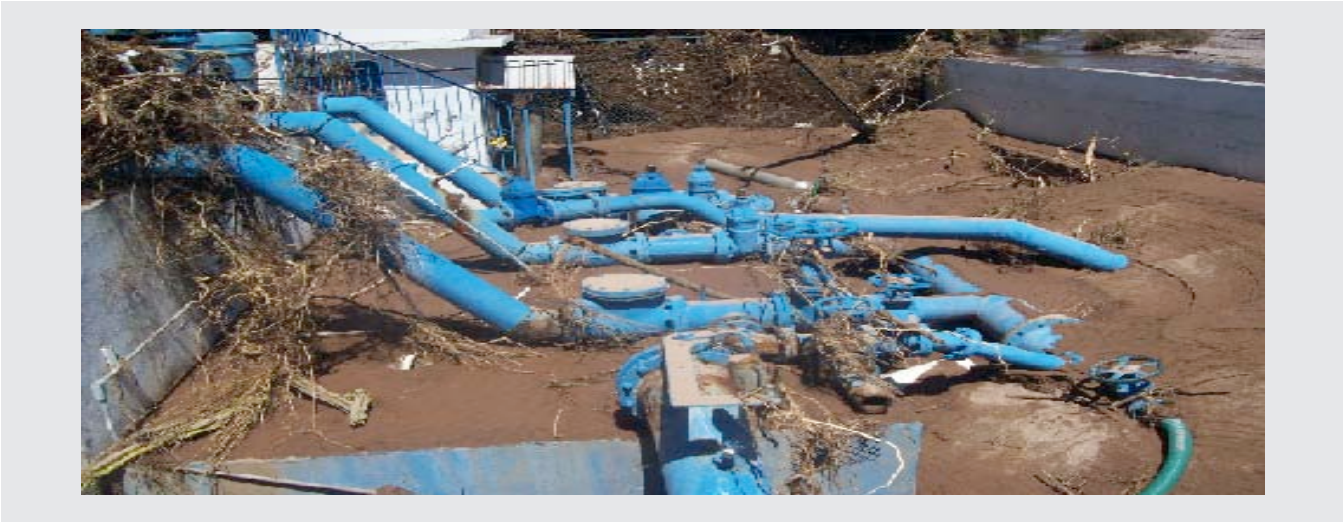
Figura 2.94 Infraestructura hidráulica en San Carlos Guaymas afectada por el huracán Jimena
