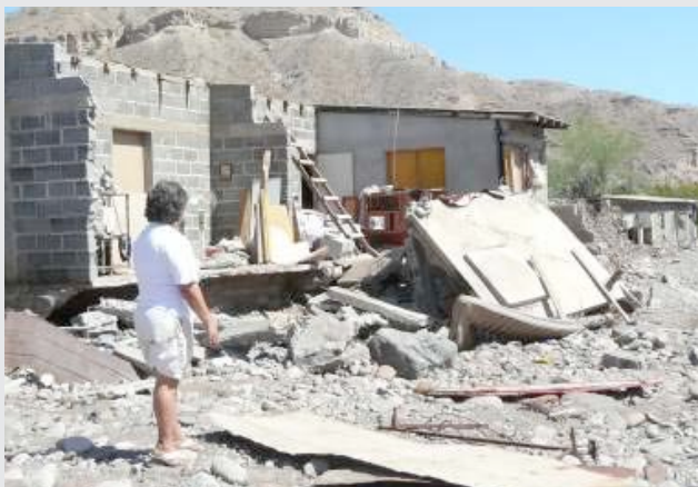
Casa colapsada por erosión en Santa Rosalía
