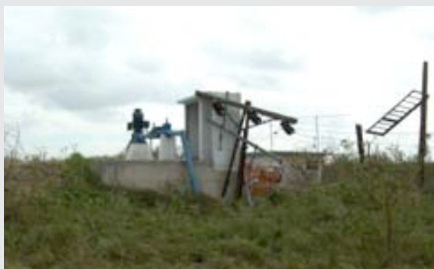
Daños en pozo las Bramonas, cd. Constitución municipio de Comondú
