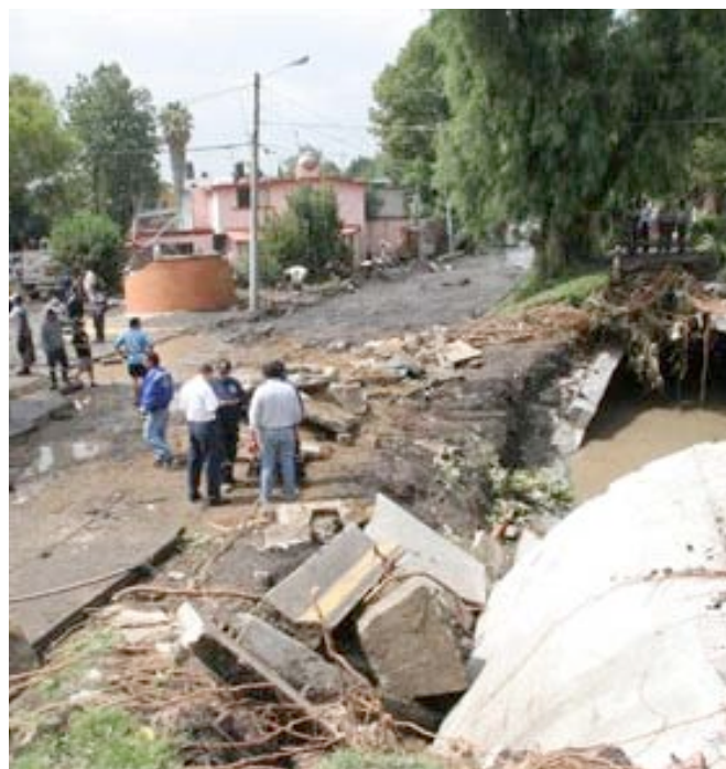
Figura 2.16 Falla del Emisor Poniente (Fuente: Gobierno del Estado de México)
