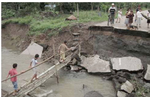
Figura 2.146 Localidades incomunicadas por daños en carreteras estatales
