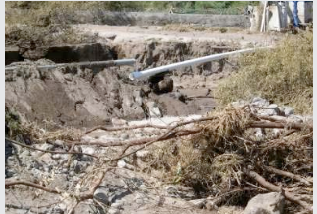
Colapso de tubería de agua potable por erosión en San Ignacio
