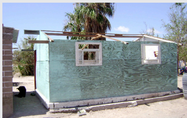
Dstrucción de vivienda en la localidad de Villa Ignacio Zaragoza, municipio de Comondú
