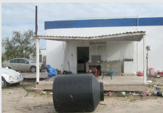
Daños en centro de salud rural de ciudad Insurgentes
