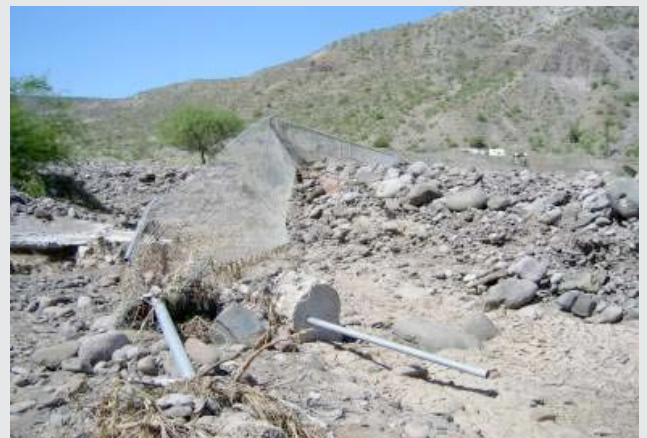
Destrucción por arrastre de sedimentos en un arroyo en Santa Rosalía
