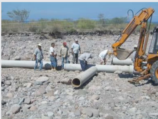
Colapso y reparación del acueducto Palo Verde, en Santa Rosalía
