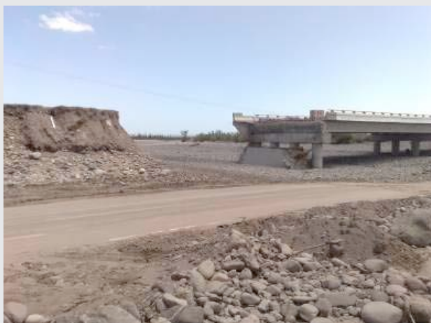
Colapso de puente en Santa Rosalía
