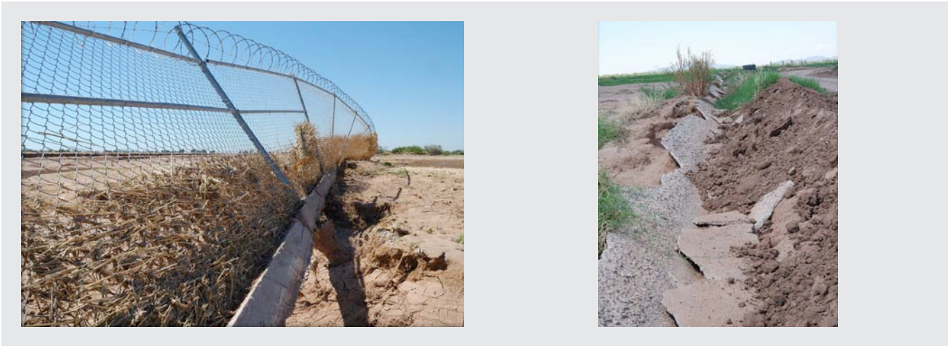
Figura 2.109 Daños en cercos y canales de riego
