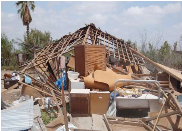
Figura 2.64 Pérdida de enseres en vivienda con daño total en el municipio de Comondú
