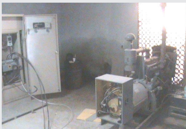
Pérdida de planta generadora del hospital general en el municipio de Comondú
