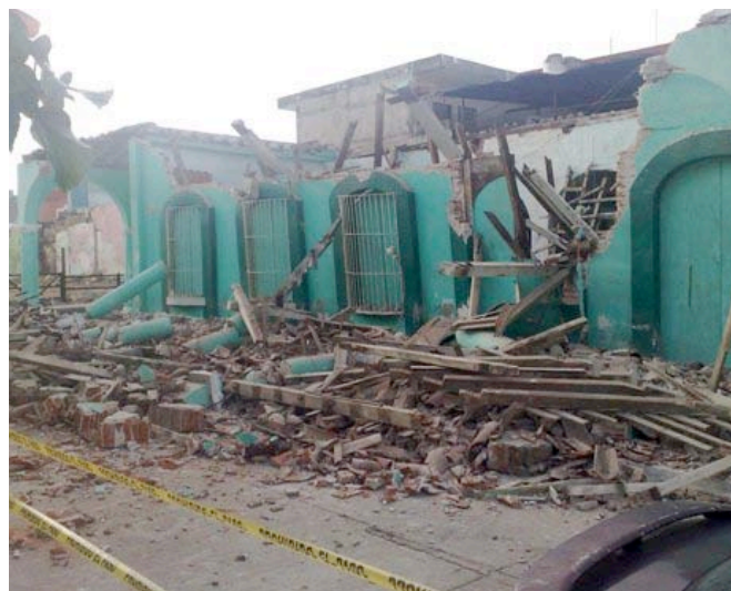
Figura 3.5 Colapso de una vivienda construida en 1836 ubicada en el centro del municipio de Alvarado (Fuente: Veracruz en red)
