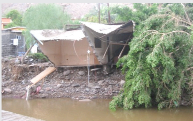
Vivienda afectada en Santa Rosalía, municipio de Mulegé
