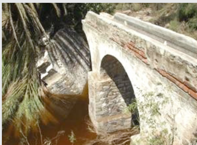
Daños en el canal La Purísima, municipio de Comondú
