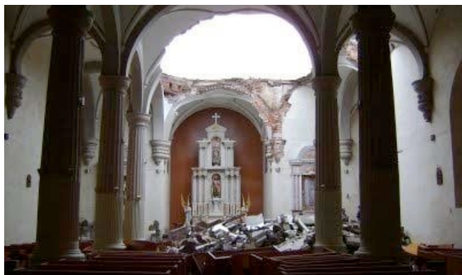
Figura 2.117 Daños en la parroquia de San Fernando, Guaymas
