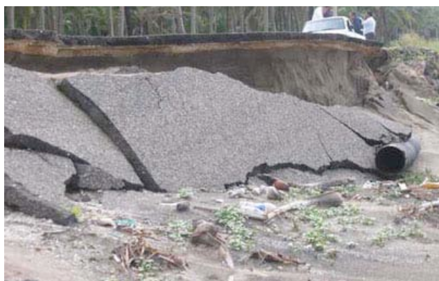
Figura 2.145 Daños en la carretera Sánchez Magallanes-Cárdenas
