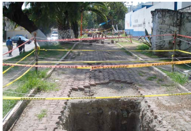
Figura 2.37 Identificación de daños sobre el túnel Emisor Poniente
