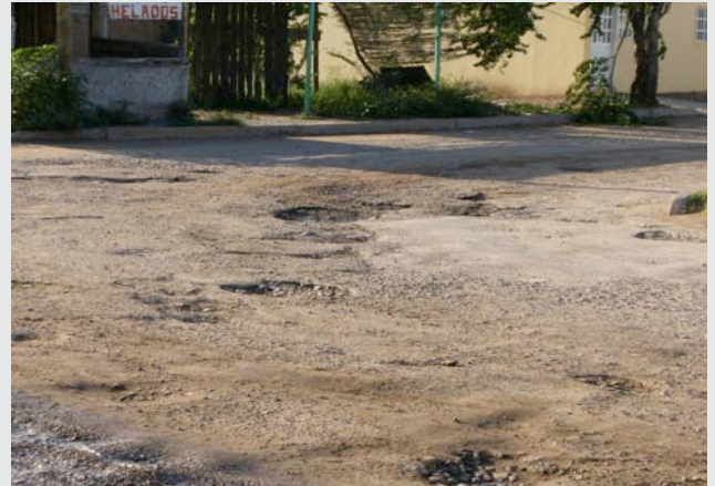
Figura 2.106 Daños en boulevard Sonora
