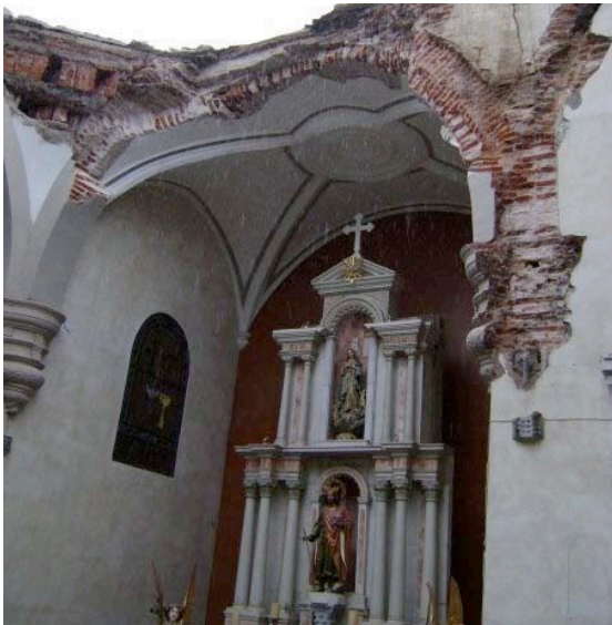
Figura 2.116 Daños en la cúpula de la parroquia de San Fernando, Guaymas
