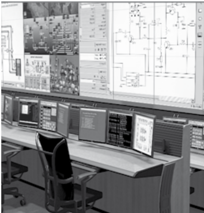
Preparación del contenido del video-wall para la inauguración de las instalaciones del CORIQ
