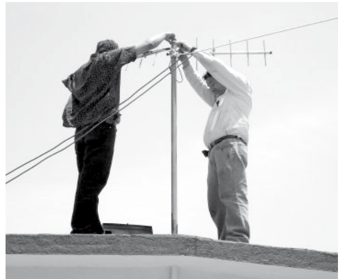
Colocación del arreglo de antenas de la estación repetidora Carabali, del SAH de Acapulco
