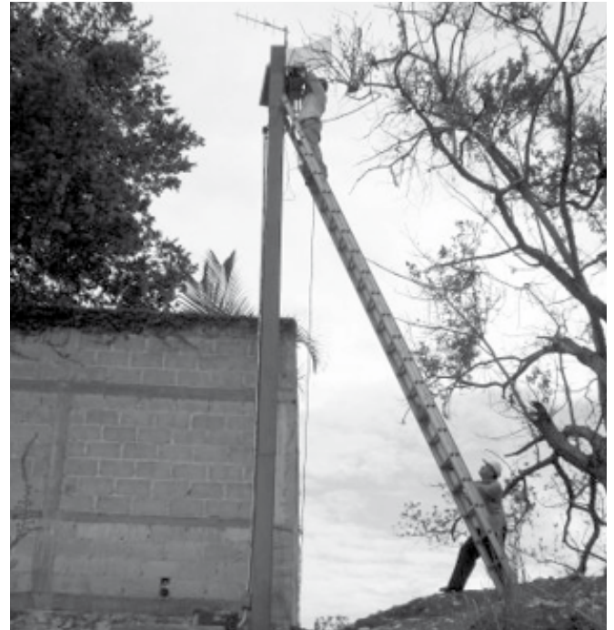
Revisión de la estación de nivel Caspestre, del SAH de Tuxtla Gutiérrez.
