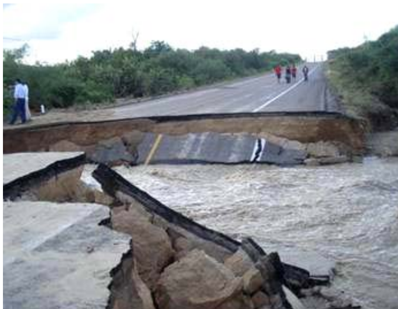
Figura 2.221 Carretera Navojoa – Álamos afectada por Norbert
