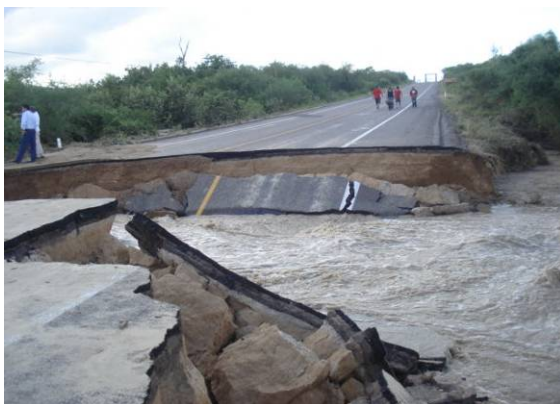
A. Socavación y arrastre del terraplén de la carretera que comunica a la población de Álamos
