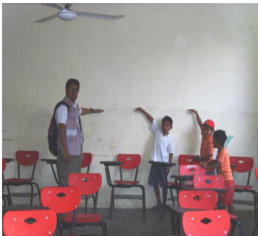
Figura 2.158 Nivel de inundación en la escuela Nicolás Bravo municipio de Macuspana
