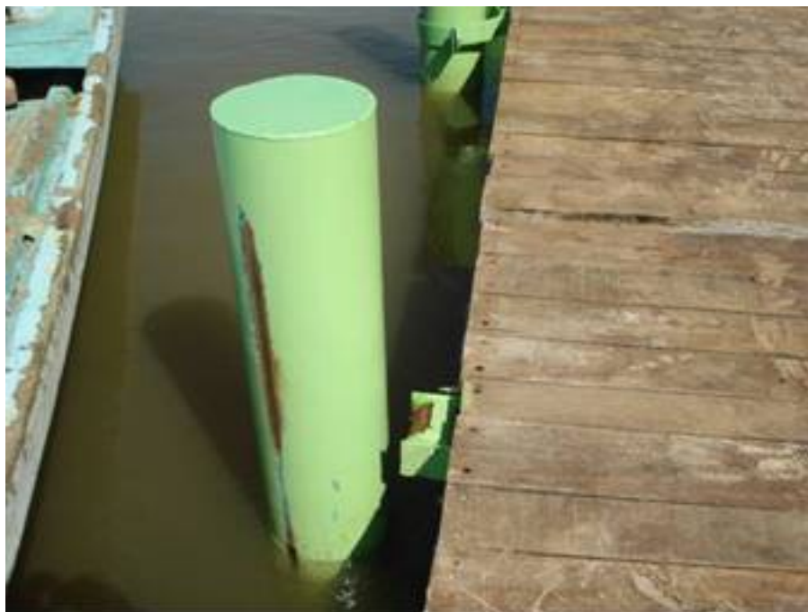
Figura 2.174 Muelle afectado por la inundación
