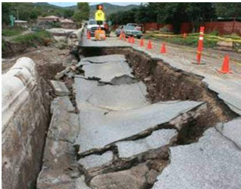
Figura 2.70 Derrumbe de pavimento en la carretera a Santa Eulalia
