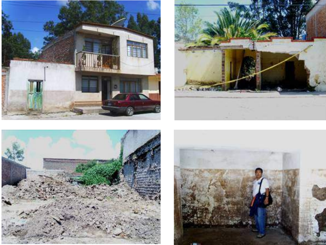
Figura 2.61 Tipos de daño en vivienda
