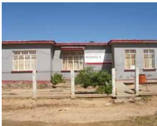
Figura 2.218 Centro de Salud afectado en la localidad de Masiaca
