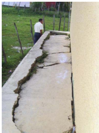
Figura 2.157 Telesecundaria con daño de tipo estructural a causa de la inundación en Bitzal
