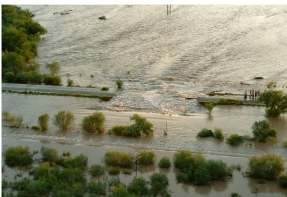
E. Ruptura de un tramo de la carretera por el flujo de agua sobre ella
