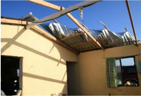
A. Desprendimiento de techos de lámina de algunas viviendas
