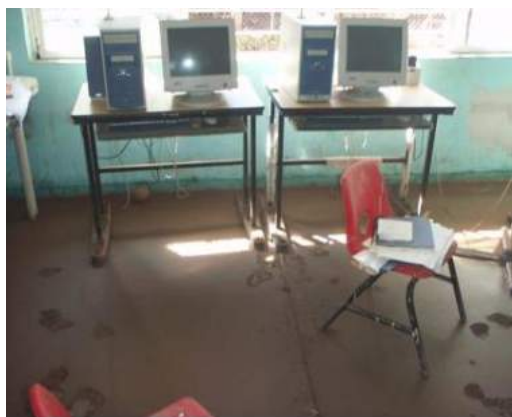
a) Daños en aula de medios de telesecundaria municipio de Huatabampo
