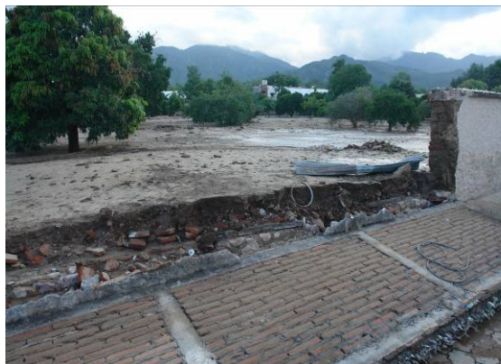
B. Volteo de una barda por el empuje de la avenida y falla de su anclaje en su cimentación
