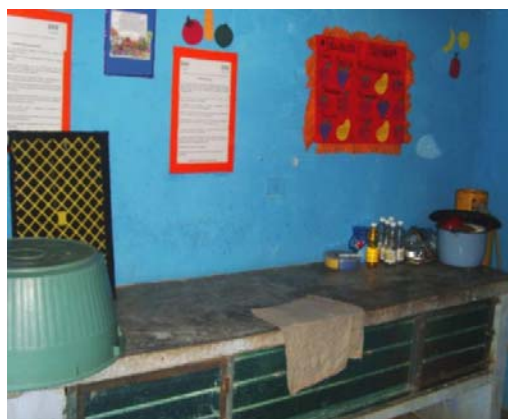
Figura 2.159 Cocina escolar inhabilitada por la inundación en el municipio de Macuspana
