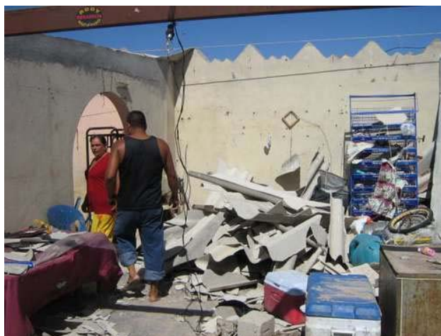
Figura 2.191 Vivienda afectada en Puerto Chale
