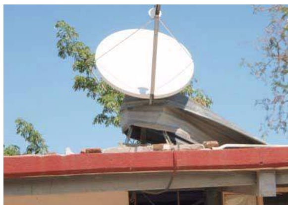
d) Antena de Edusat afectada en secundaria del municipio de Huatabampo
