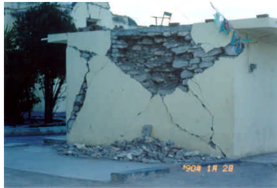
Figura 6.56 - Agrietamiento inclinado en muro de mampostería
