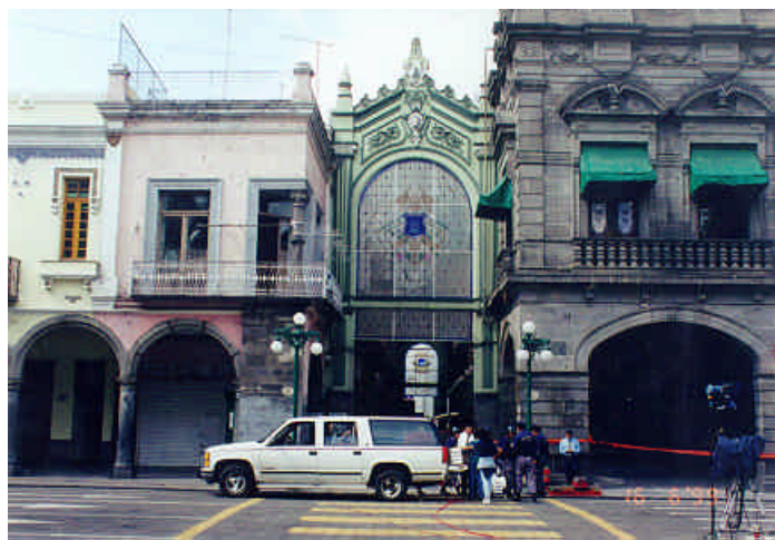
Figura 5.71 - Vitral del Pasaje Hidalgo, sin daño
