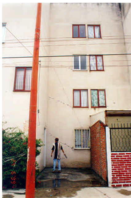
Figura 6.9 - Daño en muros de fachada del edificio 002
