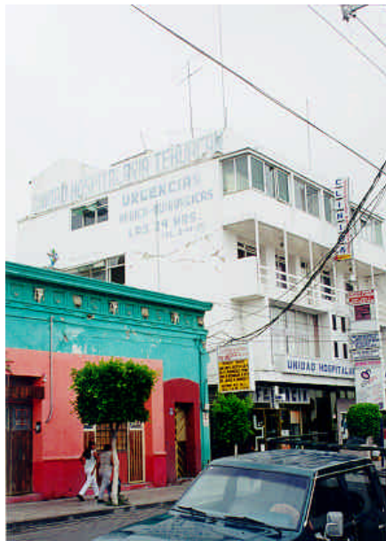
Figura 4.19 - Agrietamiento en muros de mampostería
