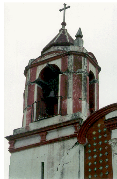
Figuras 5.43 y 5.44 - Esquema del daño exterior y detalle del daño en la torre izquierda
