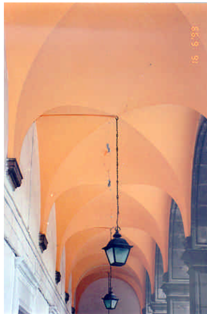
Figura 5.60 - Agrietamiento en la bóveda nervada del primer patio
