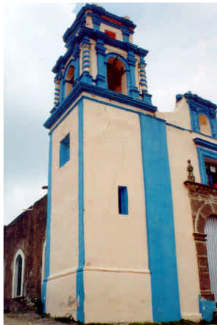
Figura 5.11 - Daño en el cuerpo de la torre de la Iglesia del Barrio de San Andrés Las Vegas
