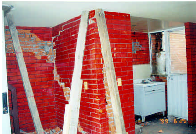
Figura 6.19 - Daño en el muro interior del eje 2
