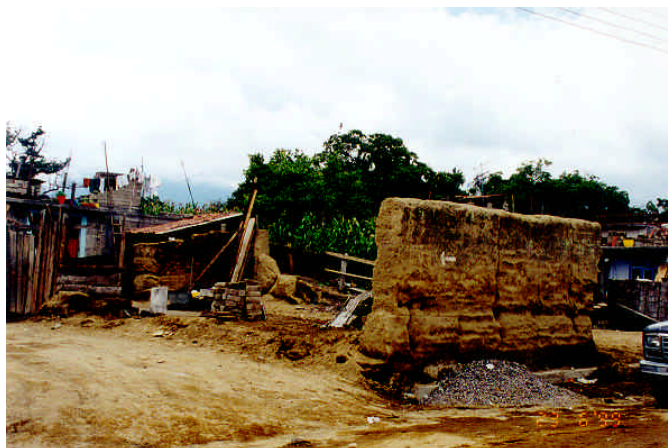
Figura 6.53 - Baja resistencia al volcamiento en muros de adobe
