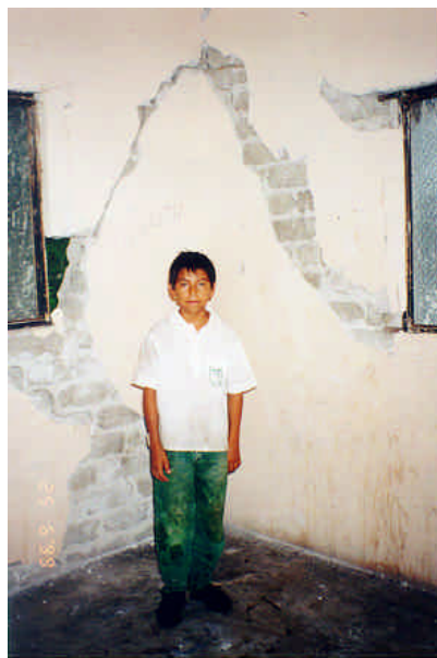
Figura 6.23 - Agrietamiento inclinado en muros de bloque de concreto
