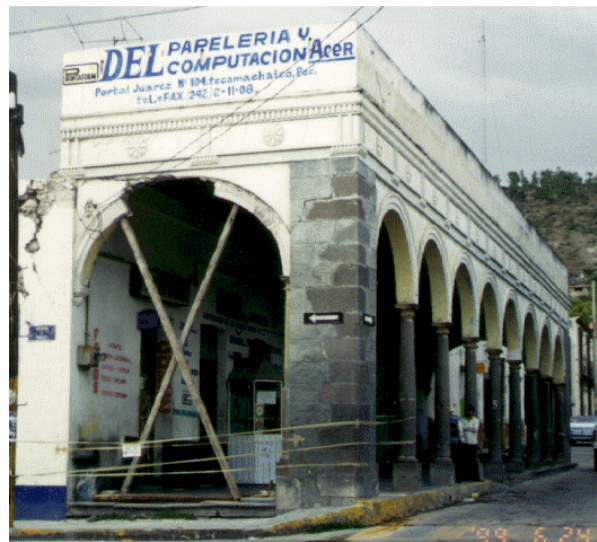
Figura 8.15 - Falla en arco de portales
