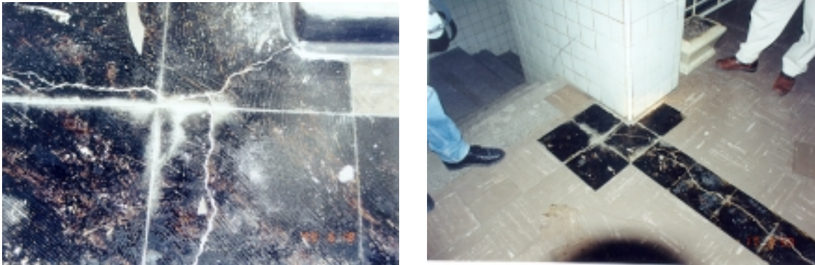
Figuras 8.8 y 8.9 - Grietas en losas
