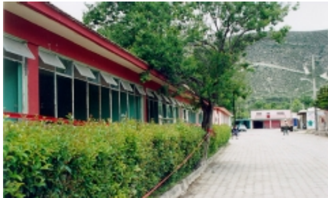
Figura 7.25 - Vista lateral de la Escuela Primaria José María Morelos y Pavón, observándose la rotura de vidrios
