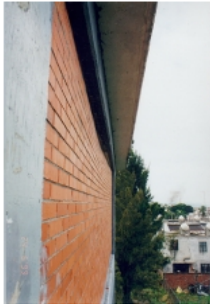
Figura 7.7 - Detalle del movimiento fuera del plano del muro extremo del edificio C
