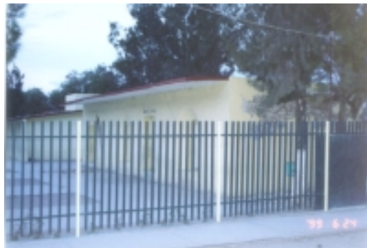
Figura 7.38 - Muro dañado en la Escuela Primaria Ignacio Allende
